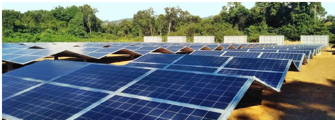
Figure 44 : Exemple d'une rangée de modules (Source : PHARES)
